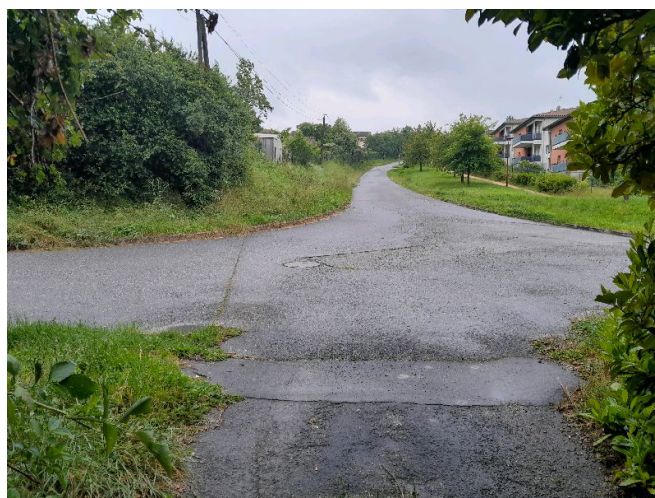
Réseau EU sous la voirie au sud du site
