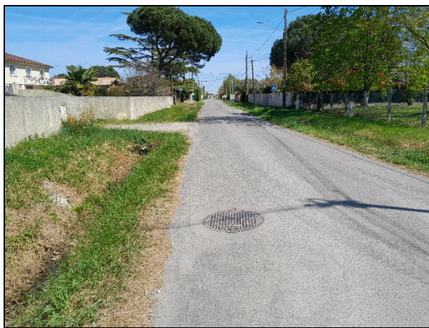
vG1 : regard (référence nivellement) du réseau EU sous la voirie du chemin de Cazalas.
